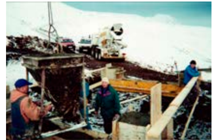
Verið að steypa undirstöður fyrir neðri endastöð Miðfellslyftunnar, auk Jóa eru á myndinni Sveinn Ingi og Palli.
